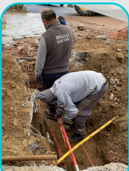
2. Bölge Elektrik Arızası
